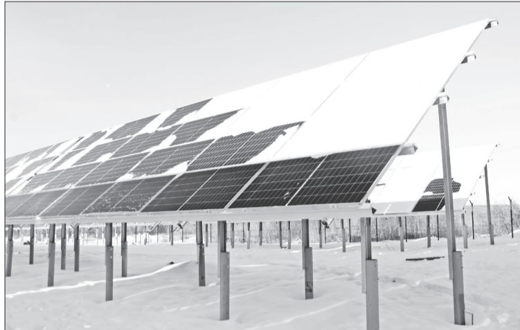
📍 Первая в Красноярском крае солнечная электростанция
